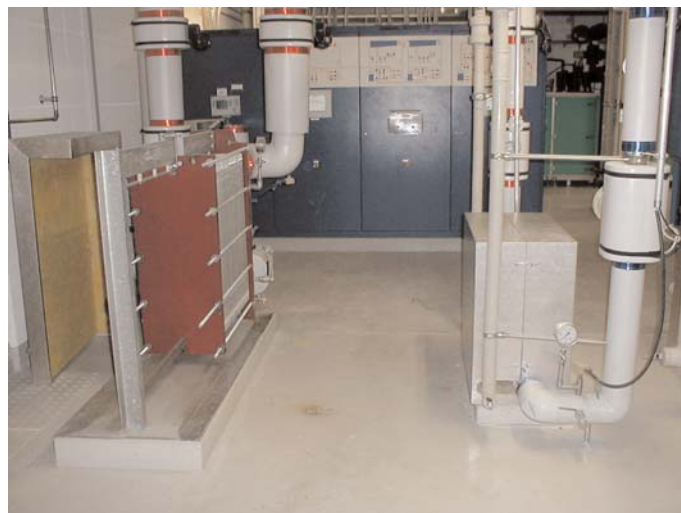
Echangeurs de chaleur
