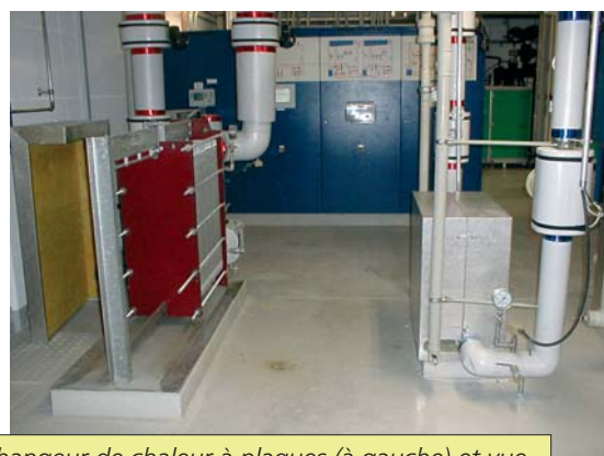
Echangeur de chaleur à plaques (à gauche) et vue partielle de la centrale de chauffage géothermique de Lavey-les-Bains (photo G. Bianchetti)
