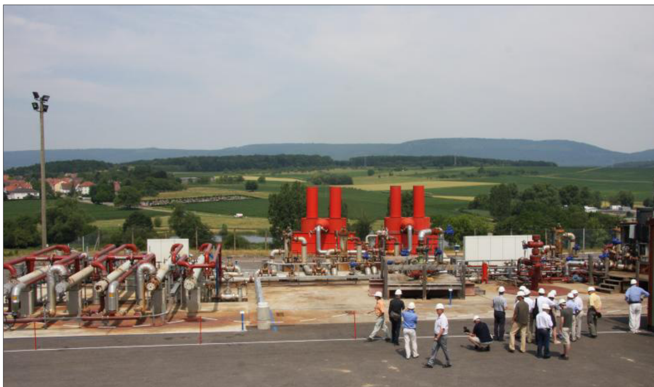
La délégation régionale sur le site de la centrale de Soultz-sous-Forêts (F). En vingt-deux ans, ce sont quelque 80 millions d'euros qui ont été investis, entre l'Allemagne, la France et l'Union européenne, dans ce projet expérimental de géothermie profonde. EBZ
